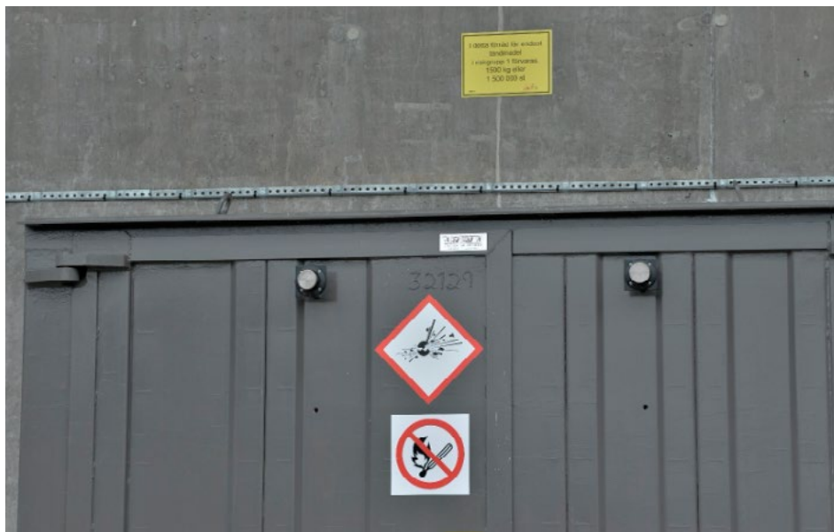
Bild 40: Skyltning av förråd för explosiva varor.
